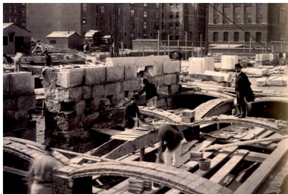
Guastavino Co. con Mc Kim, Mead & White, Boston Public Library, Boston, Rafael Guastavino i Moreno sobre uno de los arcos de la biblioteca en construcción.
